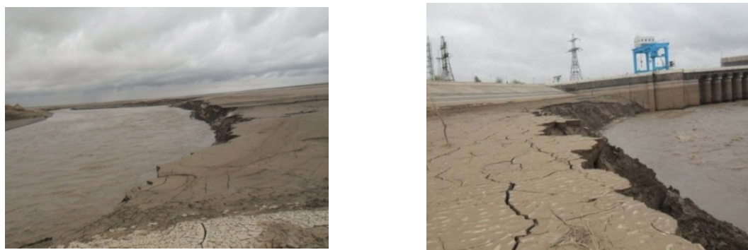
Рисунок 2 – Заилиение Руслового водохранилища
