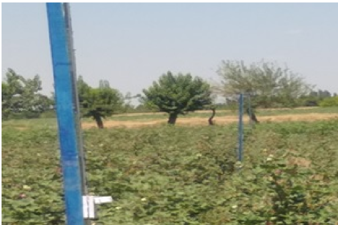
Рисунок 1. Пьезометры, установленные для изучения гидравлического процесса в системе капельного орошения фермерского хозяйства.
